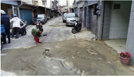
105年2月6日地震，造成台南許多地區嚴重土壤液化
