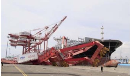
105年9月莫蘭蒂颱風造成高雄港吊掛設施損壞業重影響港區作業
